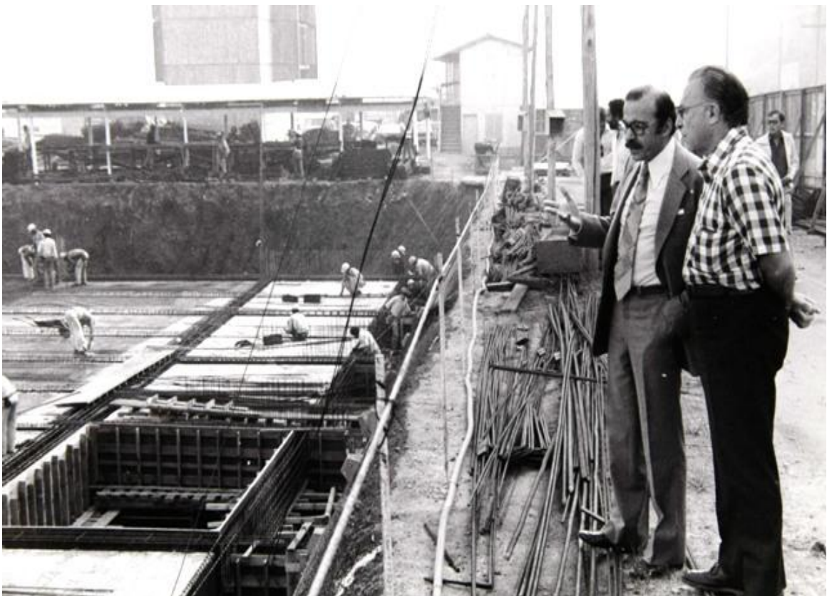
O então secretário de Cultura Mário Chamie (à esquerda) observa o andamento das obras do Centro Cultural
